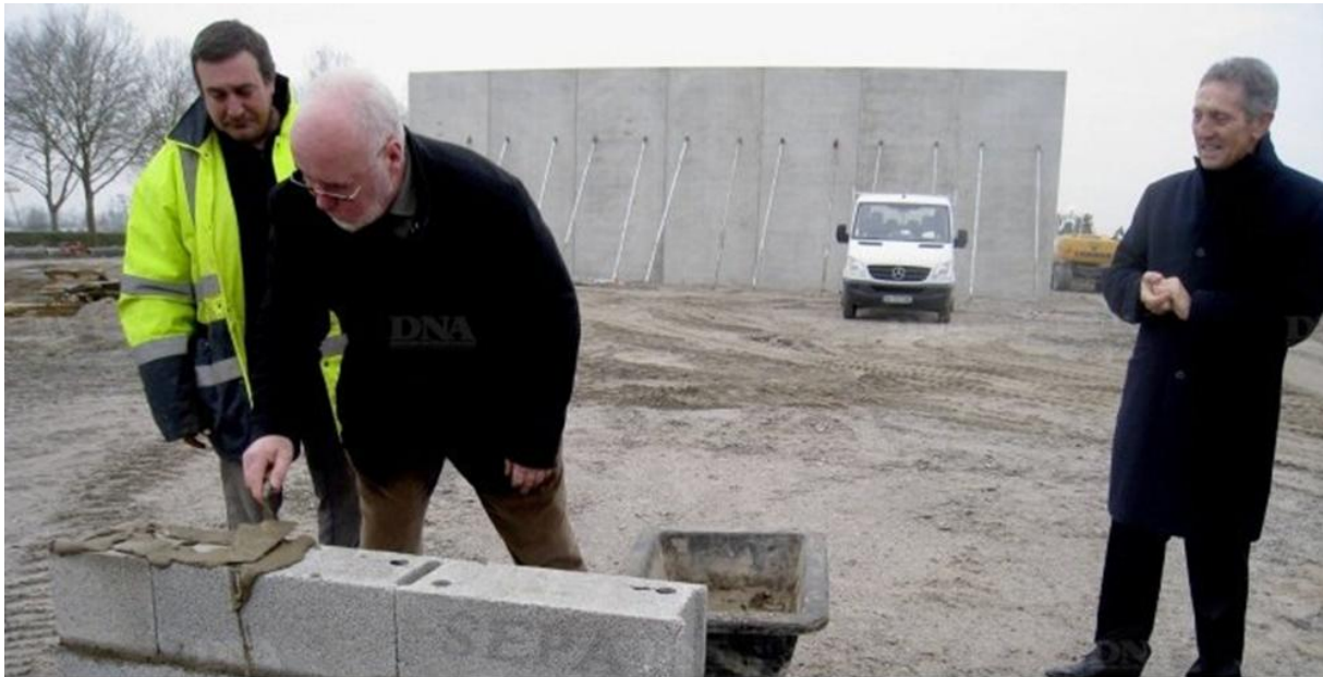
Pour manier la truelle, Gabriel Muller, maire de Kilstett, et Jean-Claude Schmitt, maître d'ouvrage (à droite), sont assistés par Serge Hoehlinger, chef de chantier. PHOTO DNA - Eva KNIERIEMEN
